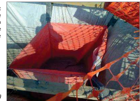
Figure 100 : Aire de lavage de toupies (Source : EDPR)
